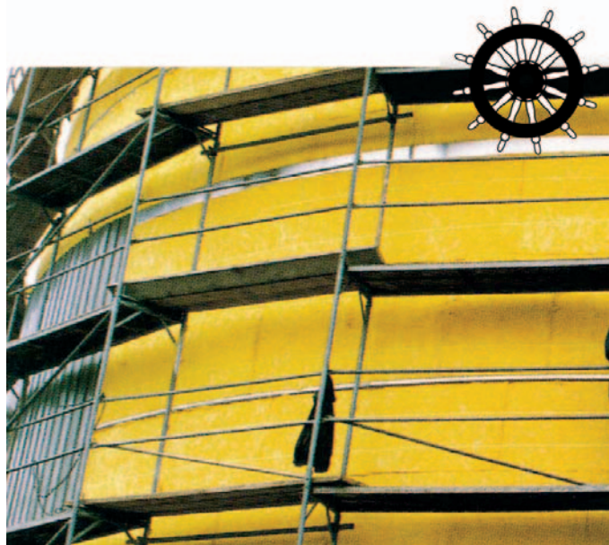
Acústica, calorifugado de depósitos y equipos
