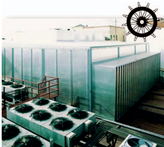
Acústica, calorifugado de depósitos y equipos
