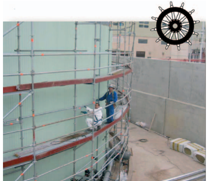
Acústica, calorifugado de depósitos y equipos
