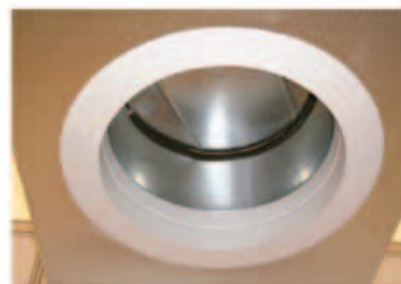
Remate lacado con Registro (falso techo)
